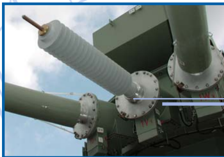
DTO1 123 kV – 1250 A
