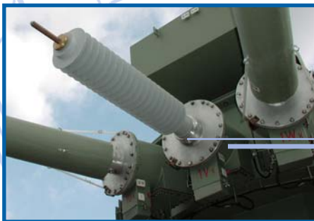
DTOI 123 kV – 1250 A
