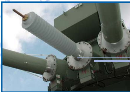
DTOI 123 kV – 1250 A
